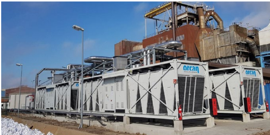
Vier Orcan efficiency PACKs, angeschlossen an die Röstanlage der Nordenhamer Zinkhütte GmbH, wo sie aus überschüssiger Wärme pro Jahr über 5.000 MWh Strom produzieren.
