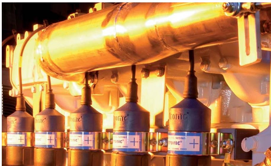
Blockheizkraftwerke von ESS überzeugen durch Zuverlässigkeit und Wirtschaftlichkeit
