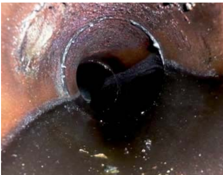
Korrosion und Ölschlamm in der Rückleitung eines Ölsystems
