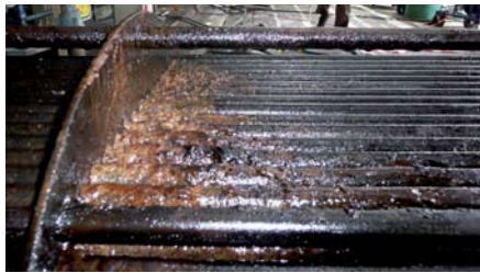
Ölschlamm im Ölkühler eines Gaskompressors
