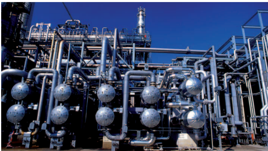
CHD-Wärmetauscher – hier wird das in die Anlage eingeleitete Produkt erwärmt, um die chemische Reaktion mit dem Katalysator in Gang zu setzen.
